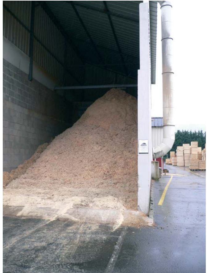
La chaufferie de 2 mégawatts est alimentée en interne.
